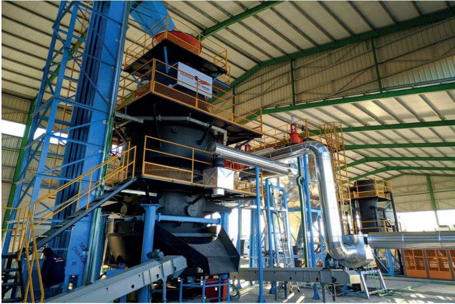
Figura 11. Instalación de gasificación de orujo graso seco. Fuente: La Cal Herrera, J.A.
