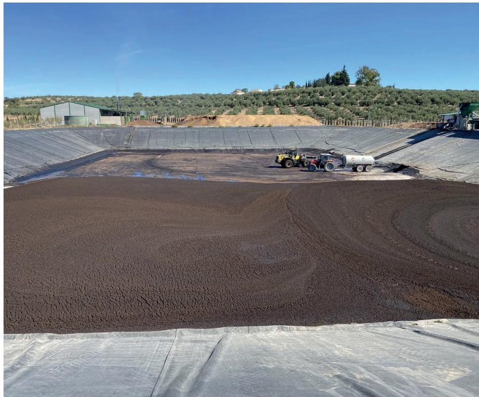
Figura 7. Balsa de almacenamiento de orujo graso con capacidad para 60 Mkg.
